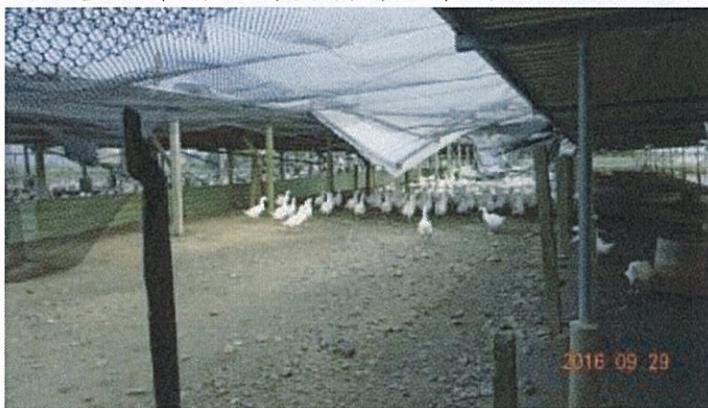
圖 3 鴨場禽舍屋頂遭強風吹落情形
