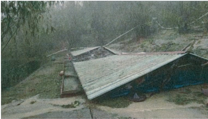
圖 7 雞場禽舍遭強風吹落傾倒情形
